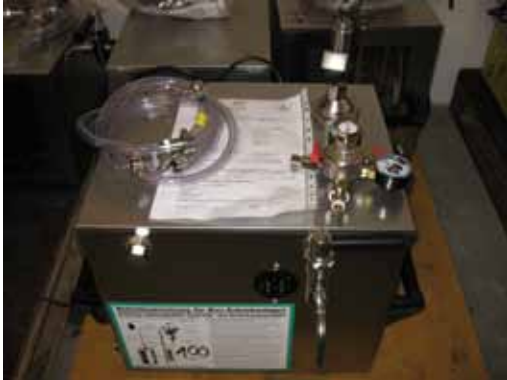
Abb. 18: Nicht verwendungsfertige Getränkeschankanlagen
