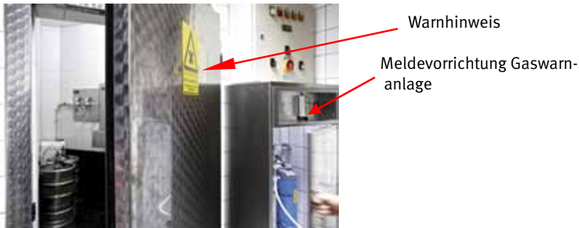
Abb. 11: Beispielhafter Kühlraum mit angeschlossenen Bierfässern; Schutzmaßnahmen: Gaswarnanlage und Warnhinweis
